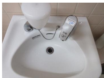
共同トイレに自動水栓機
